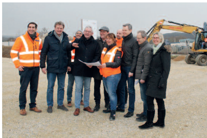
Baustellenbesichtigung südlich von Altendorf: Kreisverkehr und Bahnüberführung ersetzen den bisherigen Bahnübergang im Ort.
