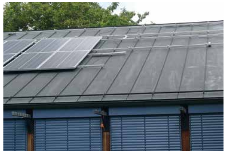
Photovoltaikanlage auf der Kindertagesstaette Sonnenblume © Markt Buttenheim
