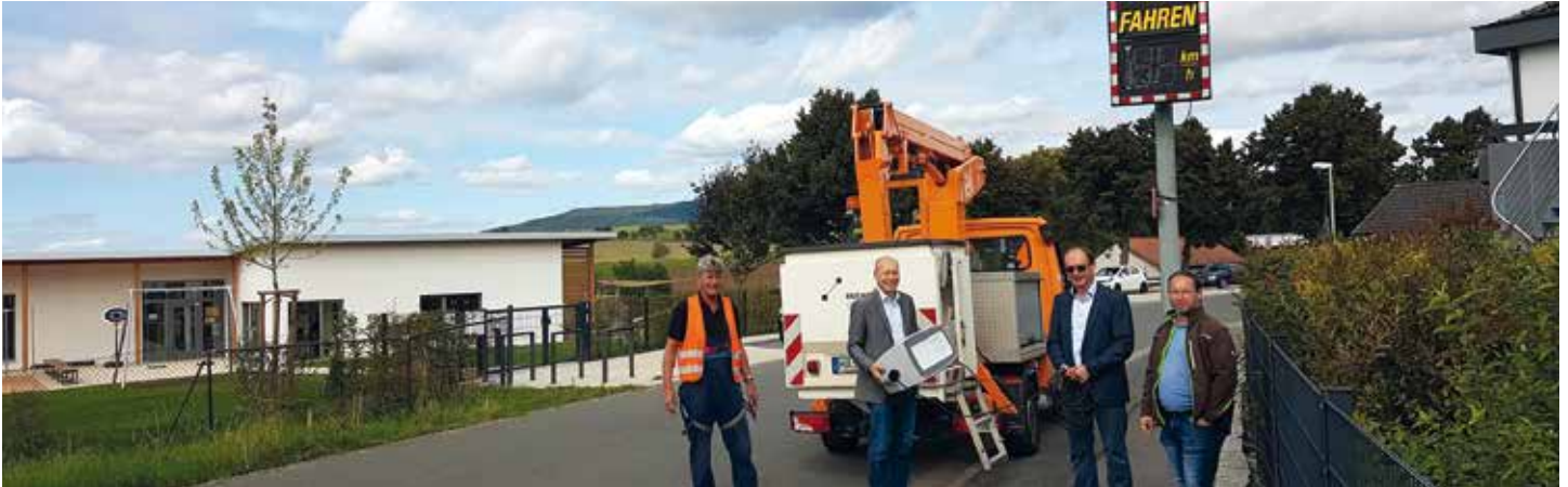
Umrüstung aller Straßenbeleuchtungen auf LED-Technik © Markt Buttenheim
